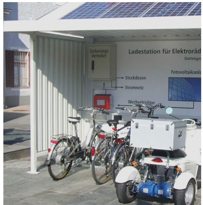
Solartankstelle in der österreichischen Solar-Modellgemeinde Gleisdorf. © Feistritzwerke steweag
